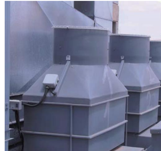
放置在屋顶的Agam除湿空调
